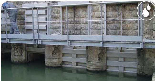
Isolément des réseaux (Vannes Murales) | Eau | FRANCE Network isolation (Penstocks) - Water - FRANCE
