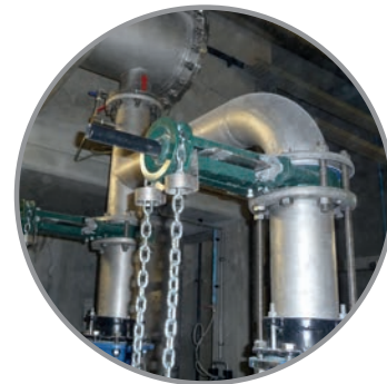
Válvula guillotina DN 150 con accionamiento por volante de cadena y su guía respectiva.
